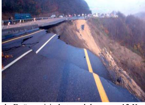
Şekil 1.2. E-5 karayolu Bolu Dağı geçişinde toprak kayması-12 Kasım 1999 Düzce depremi (Adapazarı Büyükşehir Belediyesi Arşivi)
