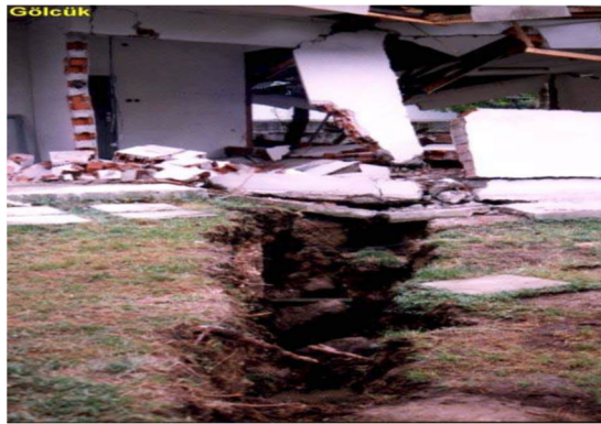
Şekil 1.1. Gölcük’te yüzeysel kırığı üzerinde bir bina (Bekirpaşa Belediyesi Arşivi)
